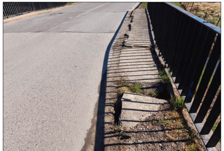
Pęknięcia konstrukcji mostu w ulicy Ostródzkiej
