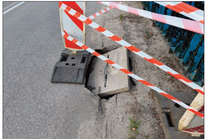
Fragmenty konstrukcji mostu wpadają do rzeki razem z płytą, która miała zakryć dziurę
