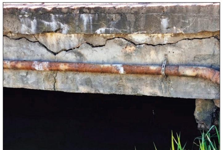
Pęknięcia konstrukcji mostu w ulicy Olsztyńskiej
