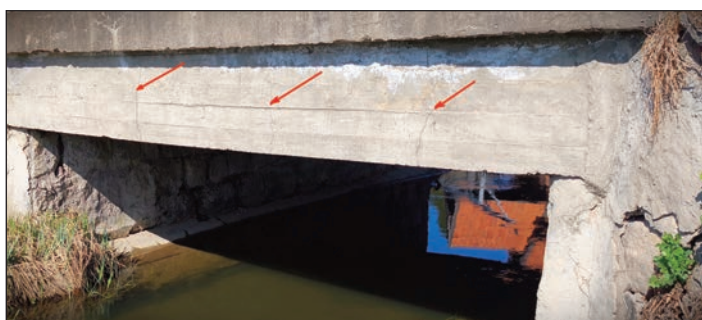
Oznaczone pęknięcia mostu w ciągu ulicy Ostródzkiej
